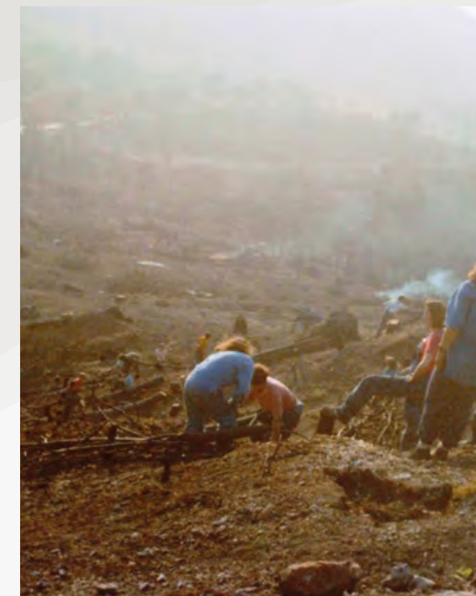
Incendie sur Sainte-Victoire le 28 août 1989 : chantier ASV de confection de fascines sur les pentes / secteur RD 17 chemin de Maurély (source : © Bénédicte de Saint-Laurent «Sainte-Victoire, le feu et le paysage, 1989-2015». ASV)
