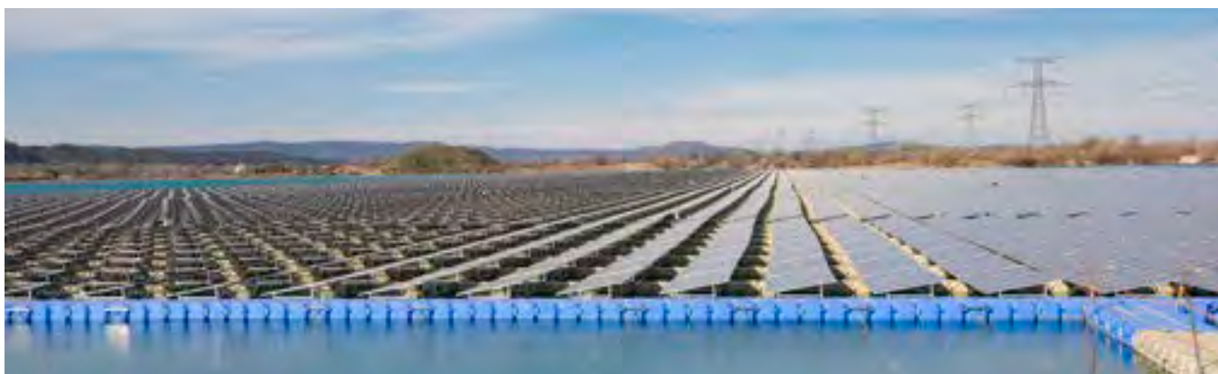
Parc solaire de Peyrolles-en-Provence © David Girard / MAMP
